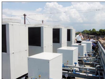
Agregaty wody lodowej – GHP – Chiller
